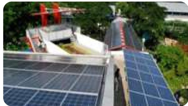
設置されているソーラーパネル
